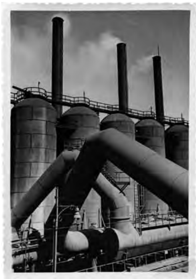
Horno alto. Estufas y tuberías de gas.
