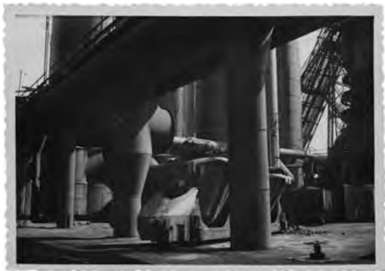
Tuberías de gas.
